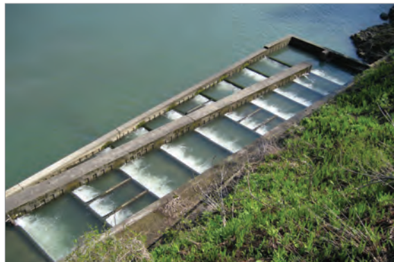
Рис. 7. Рыбопропускные сооружения. Источник: URL: https://www.energovector.com/images/upload/fishprotectzast.jpg (дата обращения: 09.11.2021)
